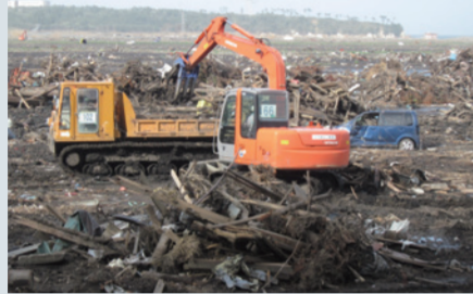
南相馬市 がれき撤去作業 (写真提供：一般社団法人福島県建設業協会)
