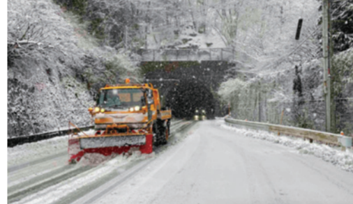
群馬県内道路の除雪作業 (写真提供：一般社団法人群馬県建設業協会)
